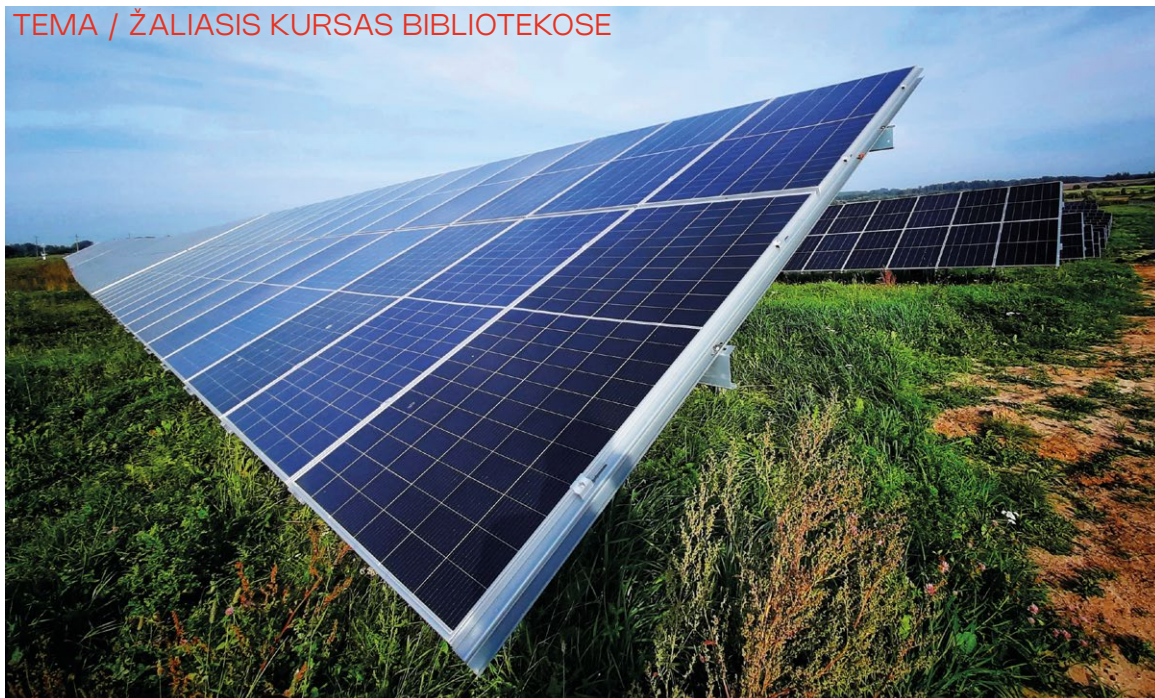
Panevėžio apskrities G. Petkevičaitės-Bitės viešajai bibliotekai dalį elektros energijos pagamina nuotolinė saulės elektrinė Molėtų rajone. 📷 Žilvinas Kropas
