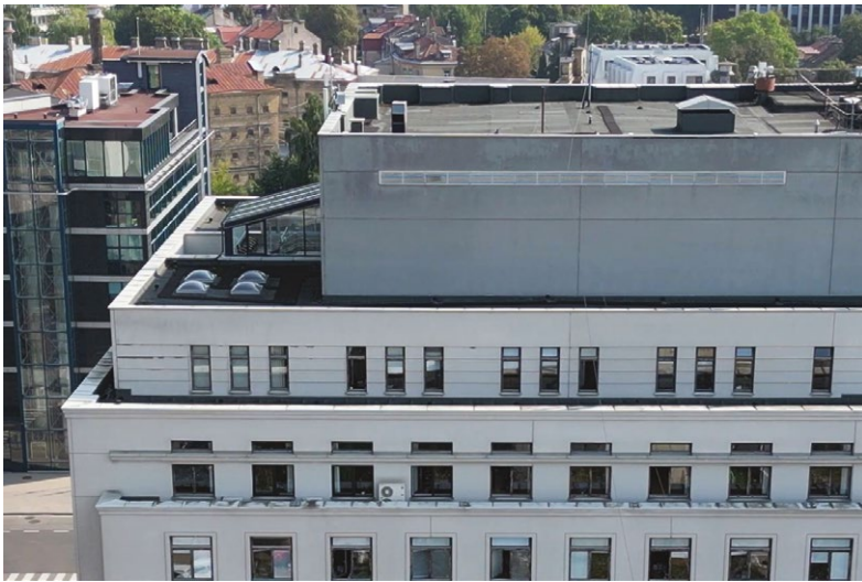
Ant Nacionalinės bibliotekos priestato stogo įrengta ir nuo 2024 m. kovo veikianti saulės elektrinė reikšmingai prisideda prie įstaigos bendro energijos poreikio mažinimo. 📷 Lietuvos nacionalinės M. Mažvydo bibliotekos archyvas
